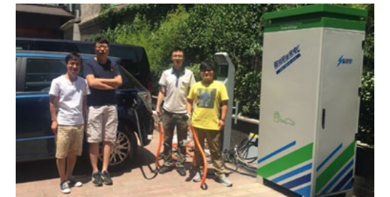
天吉客户采购了不同厂家的充电桩以便项目组调试
