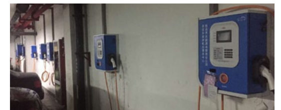
天吉能源项目充电桩设备
